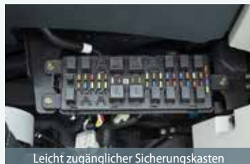
Leicht zugänglicher Sicherungskasten
